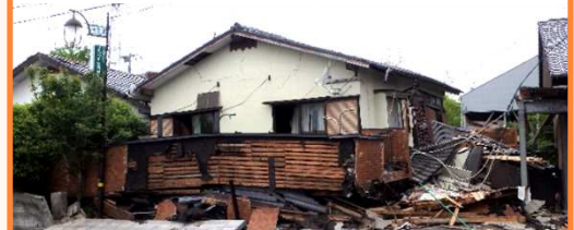
▲熊本地震で1階がつぶれた住宅
