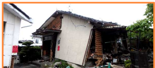
▲熊本地震で倒壊した住宅
