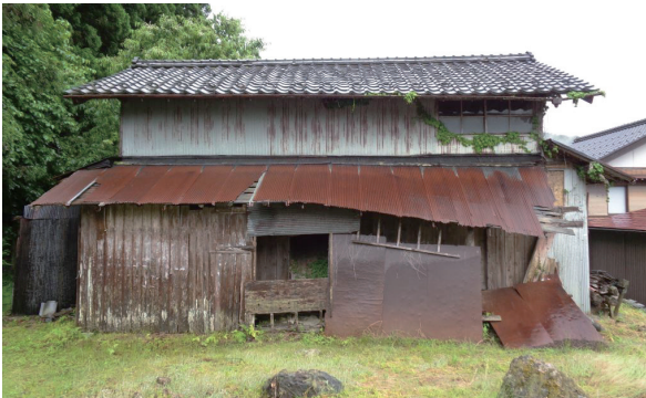
▶一部が破損した空き家▼
