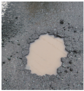
▲損傷した路面
