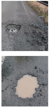
▲損傷した路面
