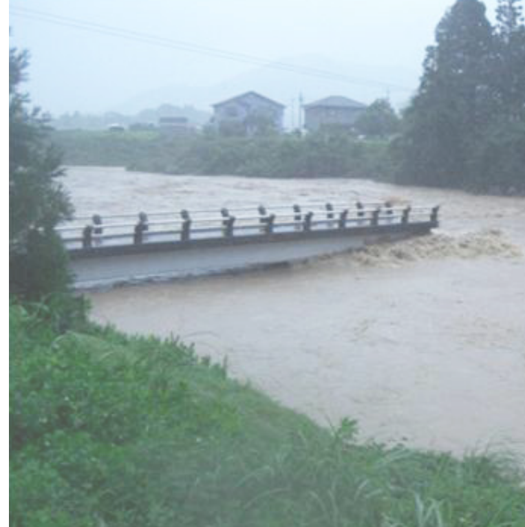
▲飛川橋流失 (平成 25 年・下中井)
