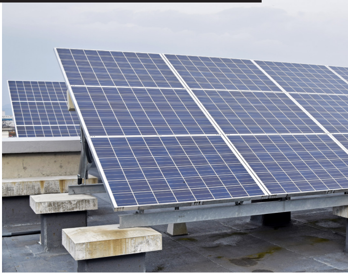
今富公民館の屋上に設置されたソーラーパネル（和久里）
