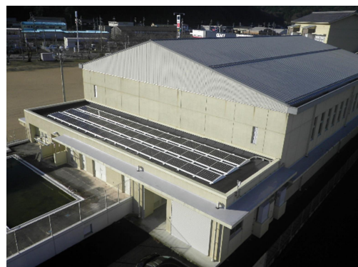
図. 3 - 1 小浜小学校太陽光発電設備
