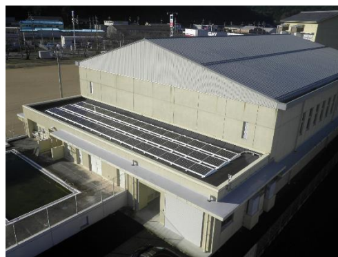
図. 3 - 1 小浜小学校太陽光発電設備
