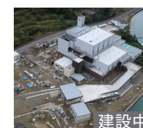
【4月から稼働】 広域ごみ焼却施設
