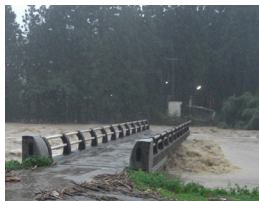
平成25年9月16日 被災時の飛川橋
