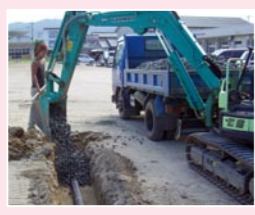
▶作業中の様子(重機を使って土を掘り、排水管を約240センチに掘削)
